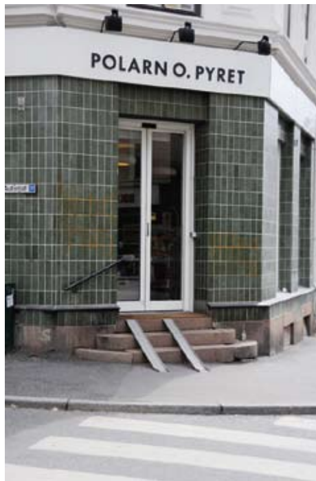
Denne inngangen ekskluderer mange og er farlig å bruke.
