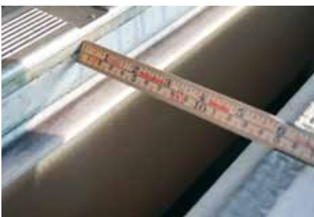
IKKE BRA NOK: Avstanden mellom tog og plattform bygges stadig for stor.
