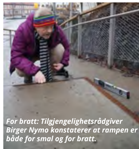
Dårlig tilgjengelighet: Rampen er så smal at elektriske rullestoler og brede barnevogner ikke kan benytte seg av den.
